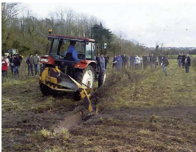
Création d'un fossé à l'aide d'une rototrancheuse lors d'une démonstration à Tréfleux.
