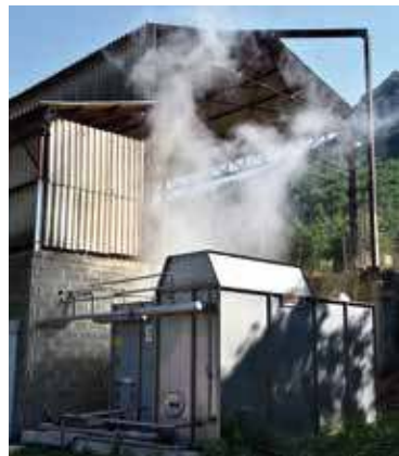
En 2017, la cuma s'est équipée d'une tour de refroidissement supplémentaire et d'une chaudière neuve.
